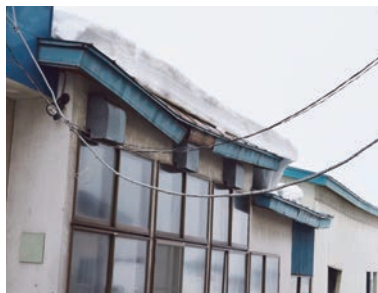
屋根からの落雪の影響で庇破損
